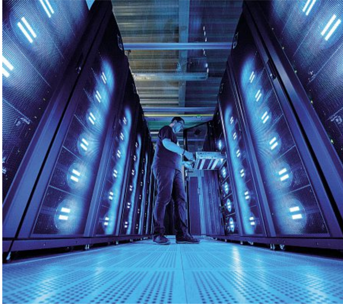
Cassaforte di dati Un tecnico informatico al lavoro in uno dei grandi data center costruito ad Amburgo, in Germania
